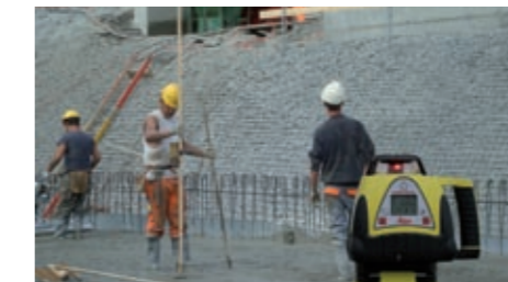
Coladas de hormigón
